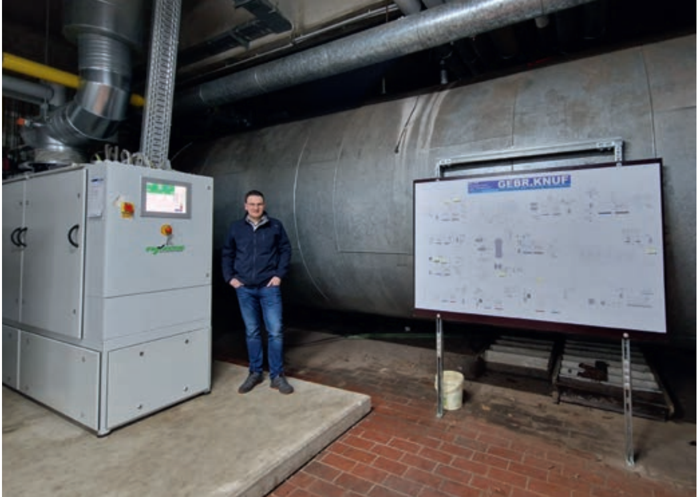
Der riesige Warmwassertank, vor dem Henning Nüsse steht, fasst 70.000 Liter. von hier bekommen alle Häuser am Hauptstandort ihr Heizungswasser.
