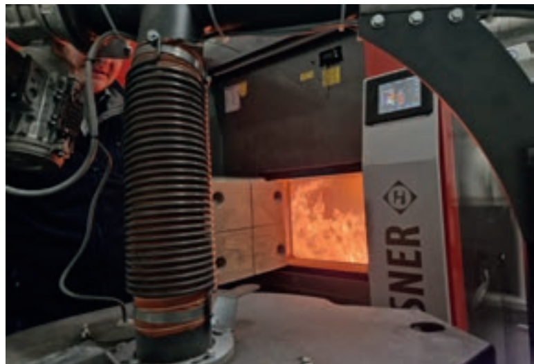
Erst geschreddert, dann gebunkert, schließlich verbrannt. Aus Altholz erzeugt das Christophorus-Werk in der eigenen Holzhackschnitzelheizung Wärme.
